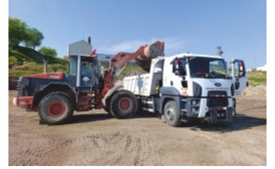
daha güvenli, düzenli ve estetik bir görünüme kavuşacağı belirtildi. Yetkililer, çalışmalar süresince vatandaşların gösterdiği sabır ve anlayış için teşekkür ederken, sürecin en kısa sürede tamamlanarak ilçenin yeni altyapı sistemine kavuşacağı ifade edildi. HABER: YASEMİN EKİCİ
